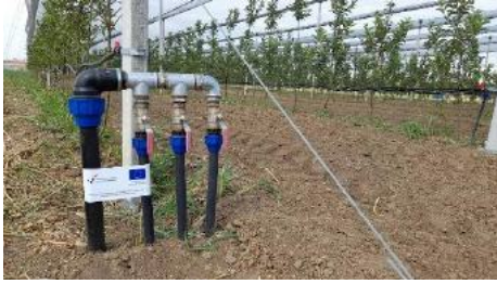
Slika 12. Sustav za navodnjavanje
